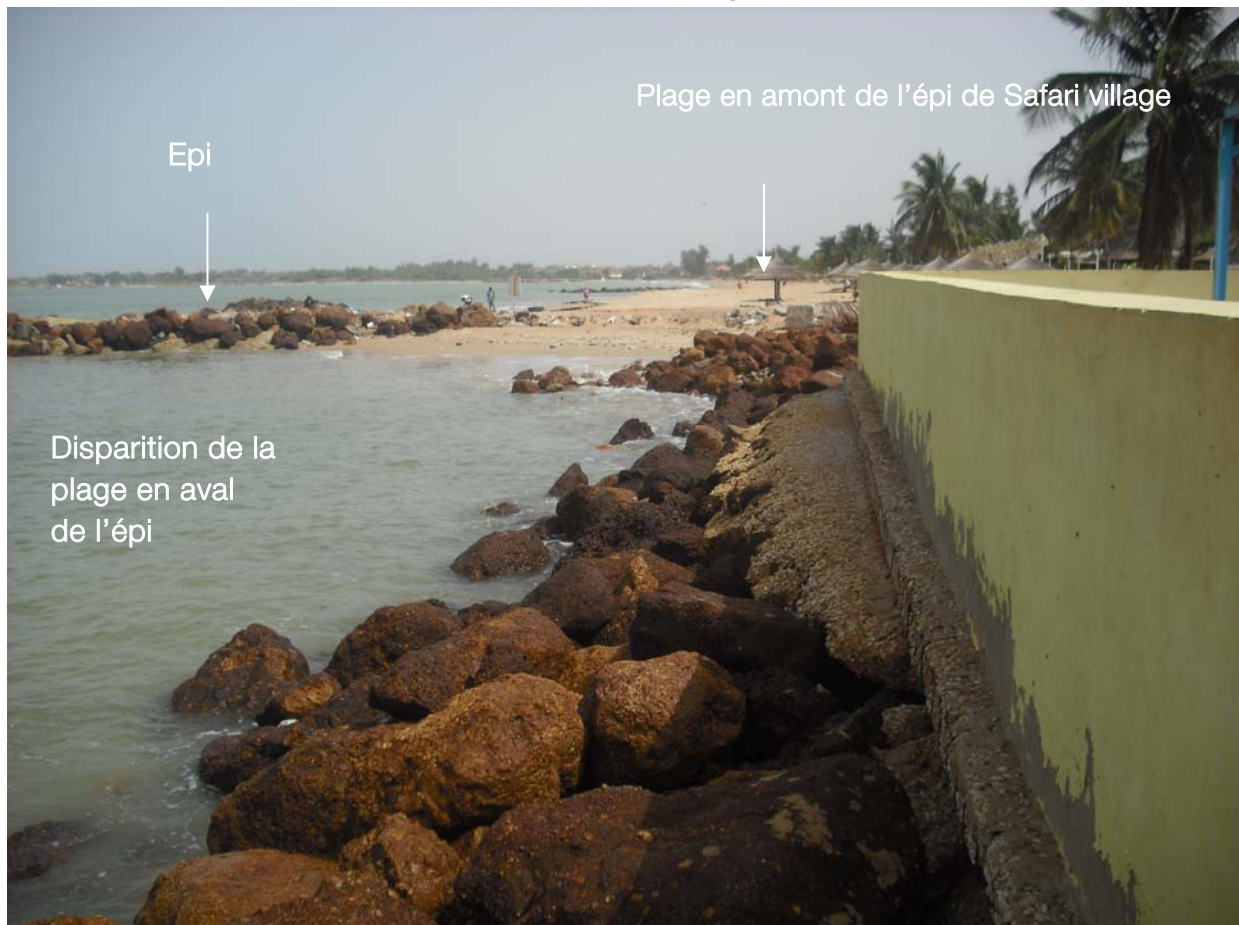
Photo 10 : Forte érosion en aval de l'épi de Safari village
