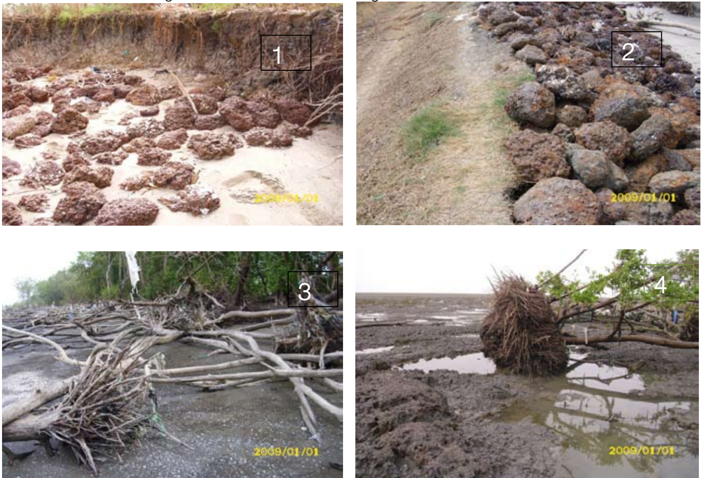
Photo 4 : Les images d'érosion au niveau de la digue de Kaback
