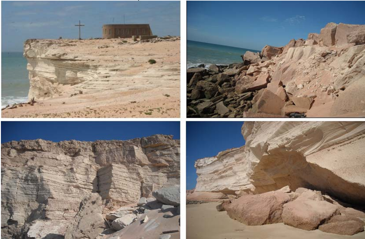
Photo 9 : Infrastructures détruites par l'érosion
