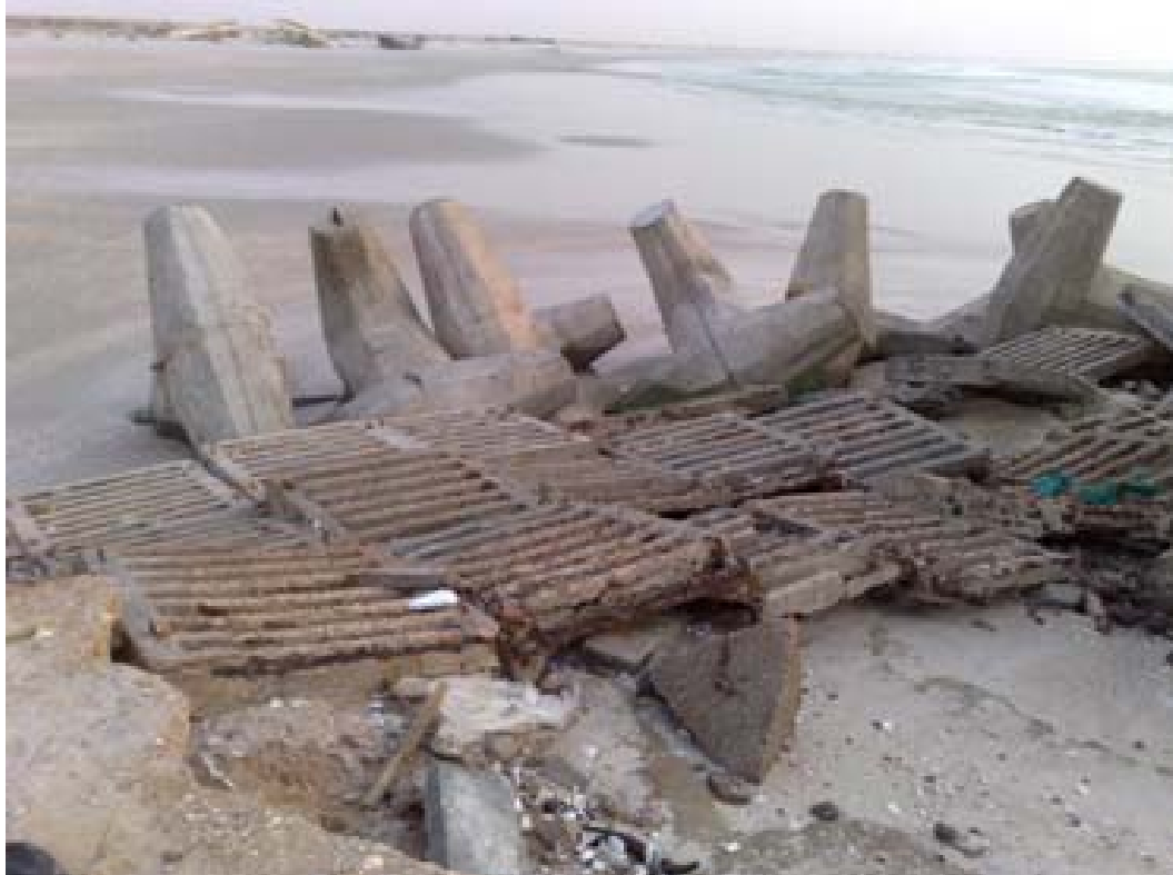
Photo 5 : Affaissement et contournement de l'extrémité de l'épi
