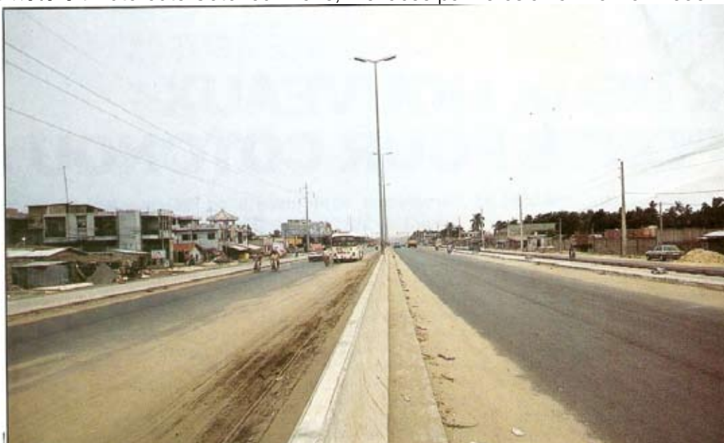
Photo 6 : Autoroute Cotonou-Krake, menacée par l'érosion à l'horizon 2050
